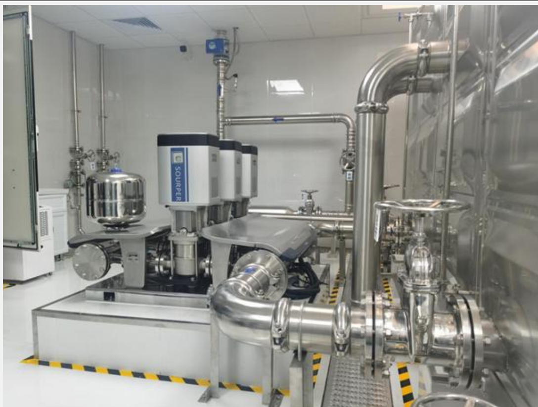
图 15 直饮水供水设备
