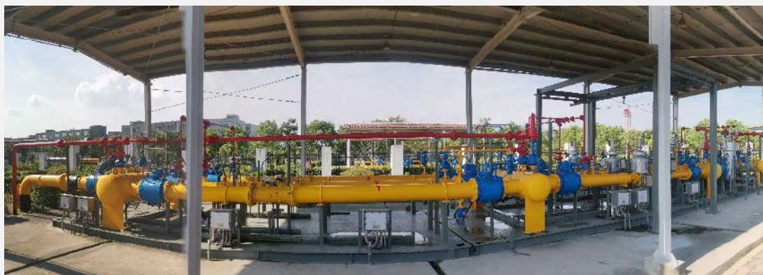
图 8 松江浦南地区天然气站
