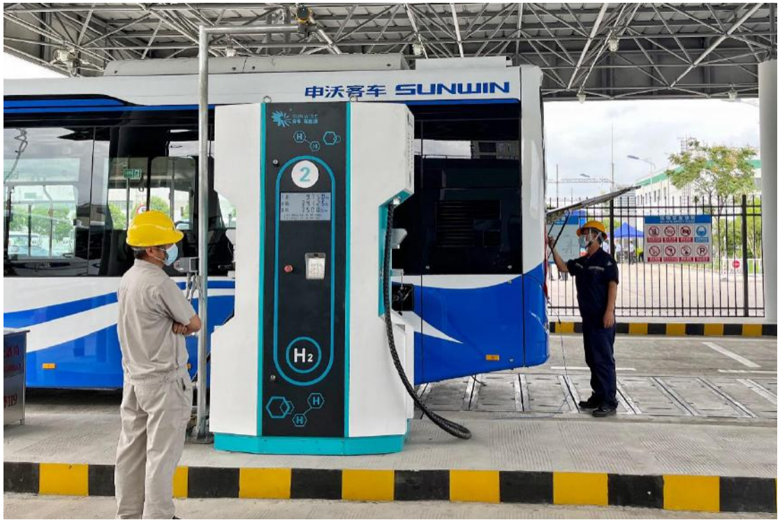
图 8 奉贤氢燃料电池公交车加氢站
